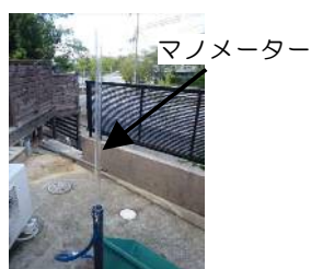
マンノメーター設置状況
